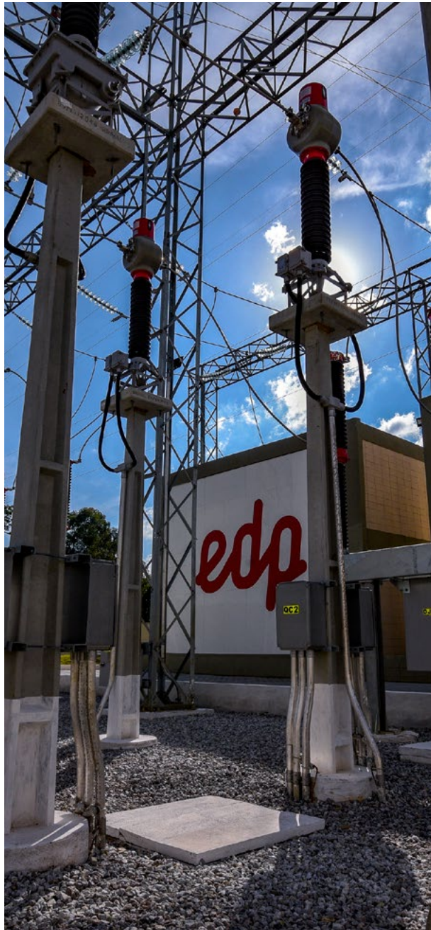
Subestação Vila Paiva – EDP São Paulo.
