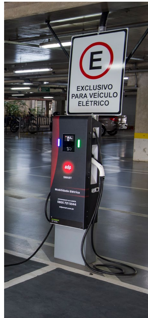
Carregador elétrico para veículos.
